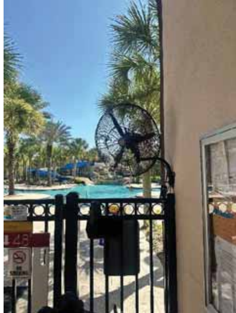
Pool Entrance Fan
